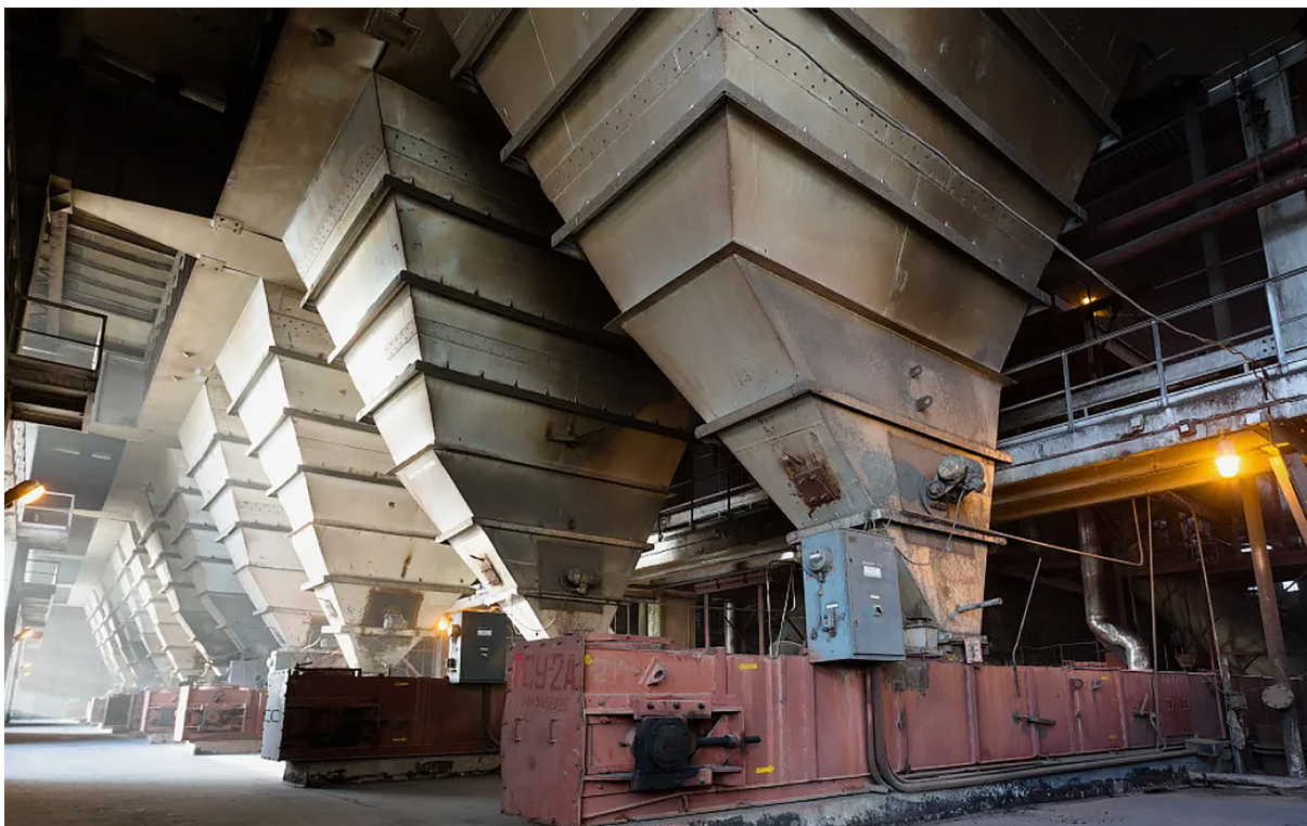
Угольный котел ТЭЦ
